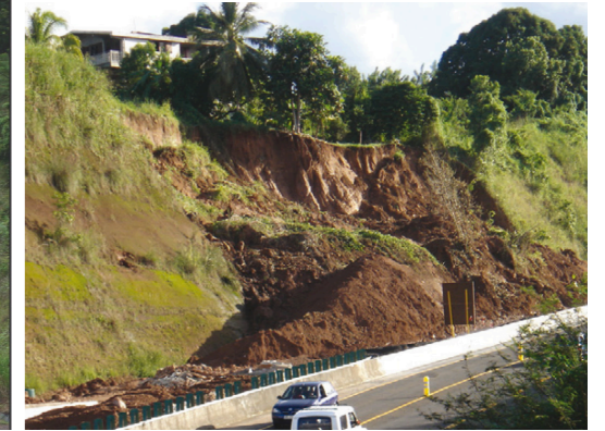
Eboulement sur la RN1 (Morne-Bourg, 2001)
