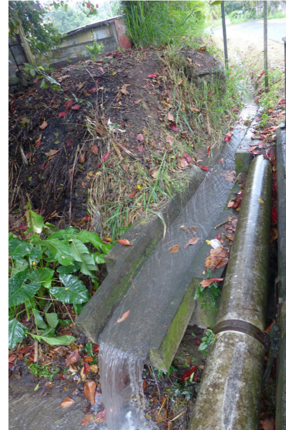
Mauvais État du réseau de collecte des eaux pluviales
